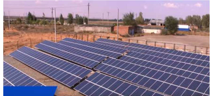
Промышленная сетевая СЭС 250 кВт, питающая насосы солнечной тепловой в р-не Астрахани котельной
