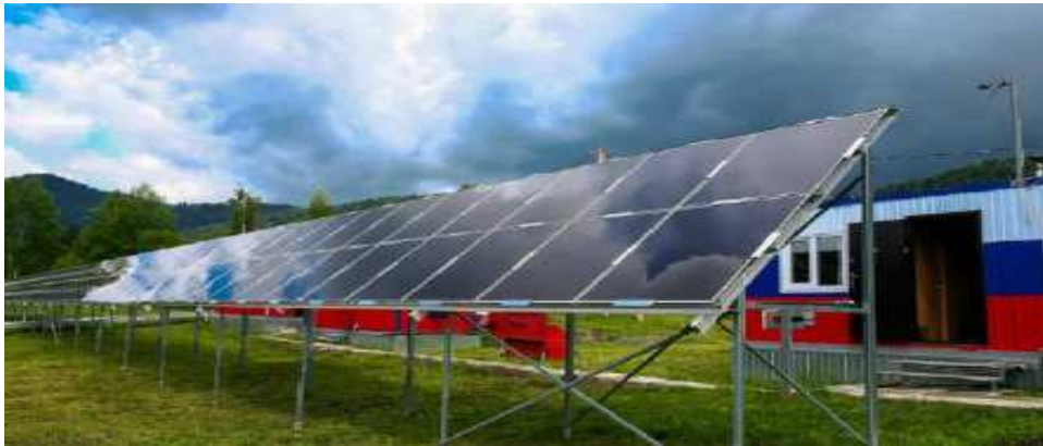
Автономная гибридная дизель-солнечная энергоустановка 100 кВт Республика Алтай
